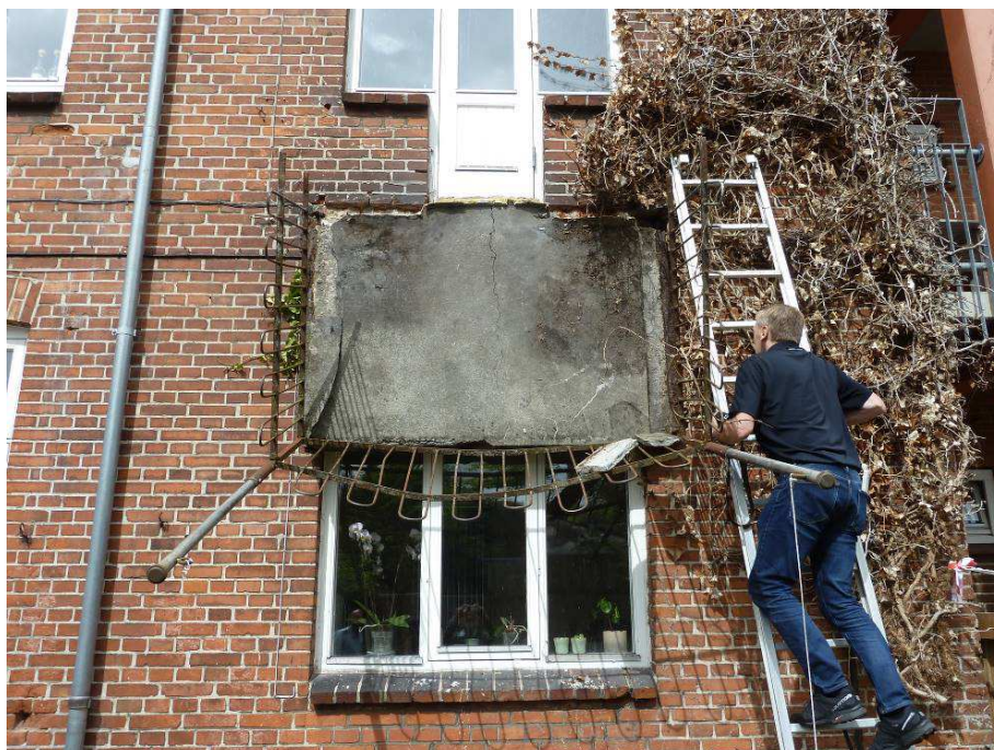
Figur 3. Facade med altan efter kollaps.
