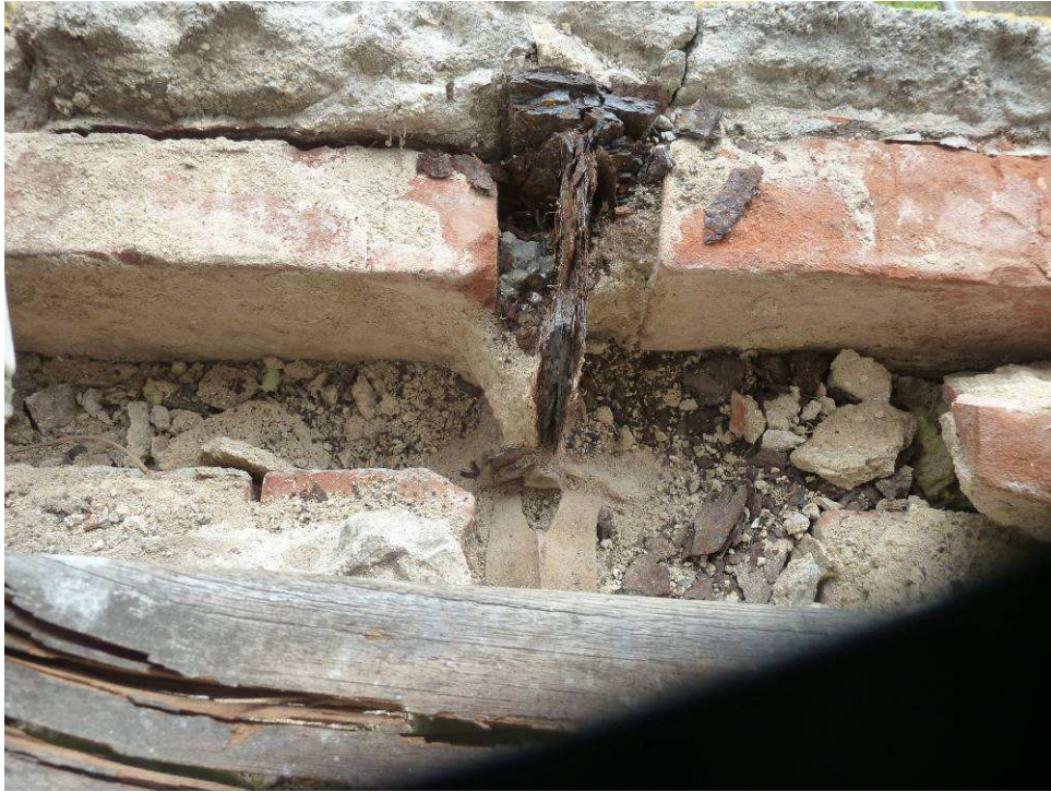
Figur 5. Brudsnittet i det midterste udliggerjern set mod altanpladen. Her ses den bøjede underflange samt korroderede dele af den øvrige del af tværsnittet. Det kan se ud som om overflangen har et friskt brud.
