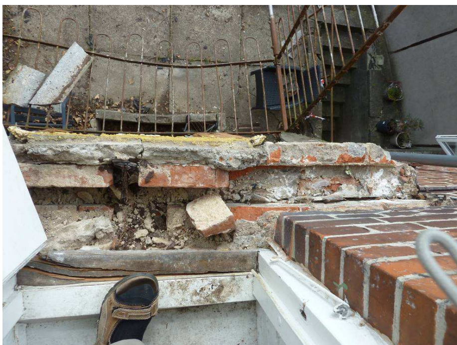
Figur 4. Foto fra altandøren. Man ser skaden på dørtrinnet samt mursten, som er trukket ud af muren som følge af at de er støbt fast i pudslaget.
