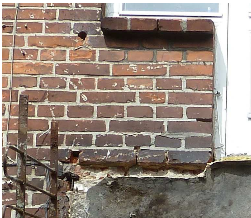
Figur 13. Del af rækværk på altan. Man ser hullerne i væggen, hvor rækværket har været indmuret, samt de ender af rækværket, som har været indmuret.
