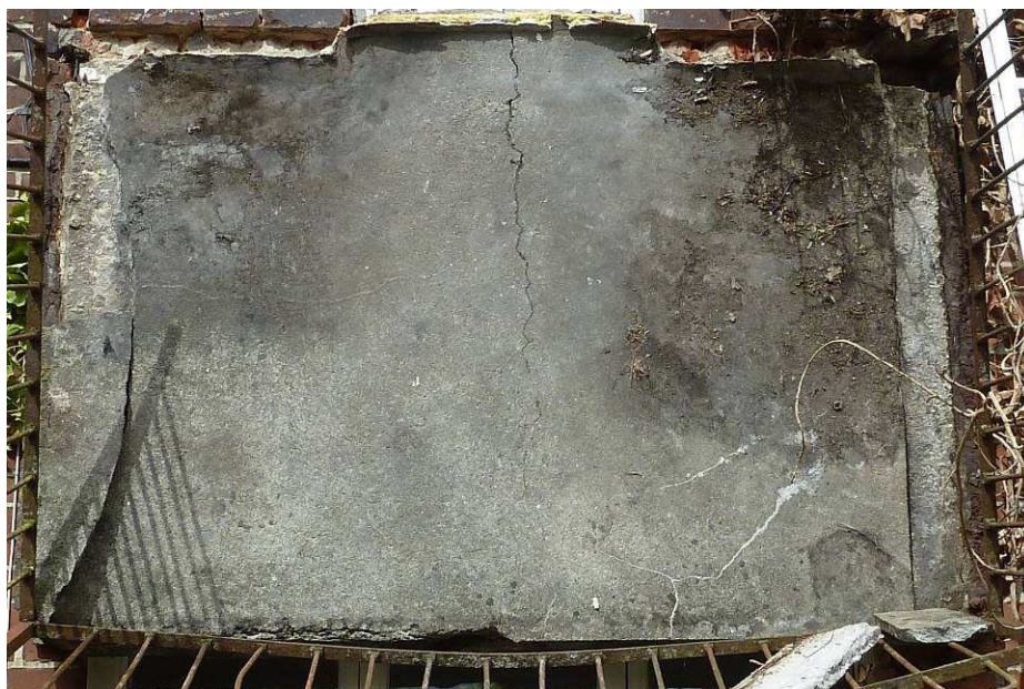
Figur 16. Oversiden af den kollapsede altanplade.
