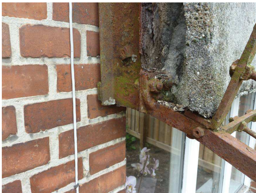
Figur 12. Detaljer fra et hjørne af altanen. Heraf fremgår fastgørelsen af rækværk til udliggerjern samt bolt til fastholdelse af trækbånd – bolten i den modsatte side var forsvundet.
