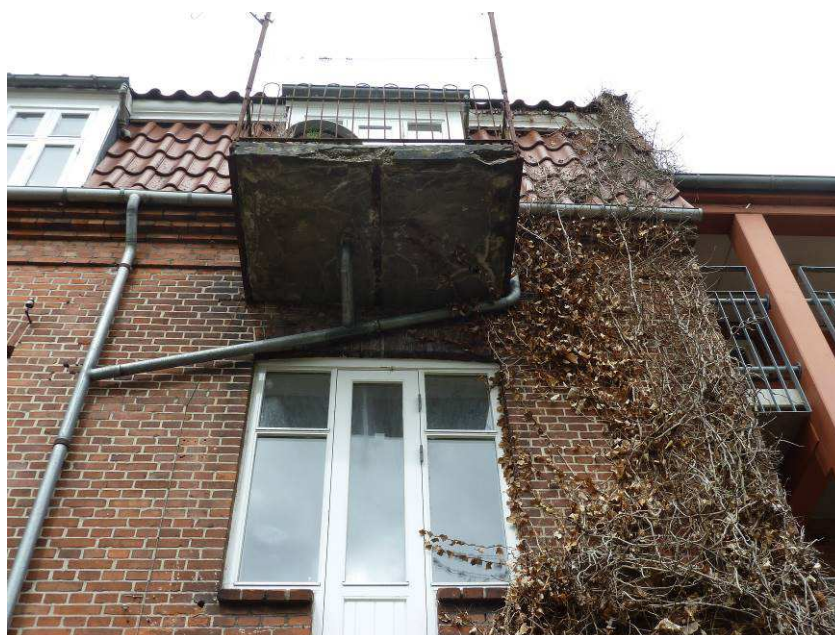
Figur 19. Altanen ovenover den kollapsede altan set nedefra.
