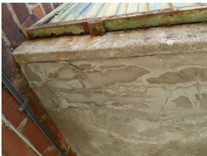
Figur 11 Delaminering af overflade
