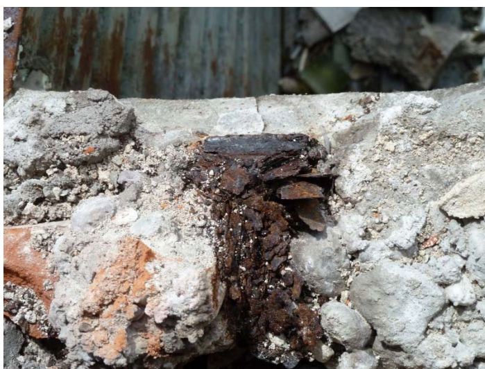
Figur 8 Tværsnit af udliggerjern i altanpladen, modsat side af altandør
