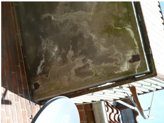
Figur 10 Underside af altan med blottagt udliggerjern
