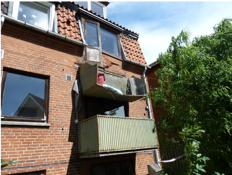
Figur 1 Intakt altan og kollapset altan
