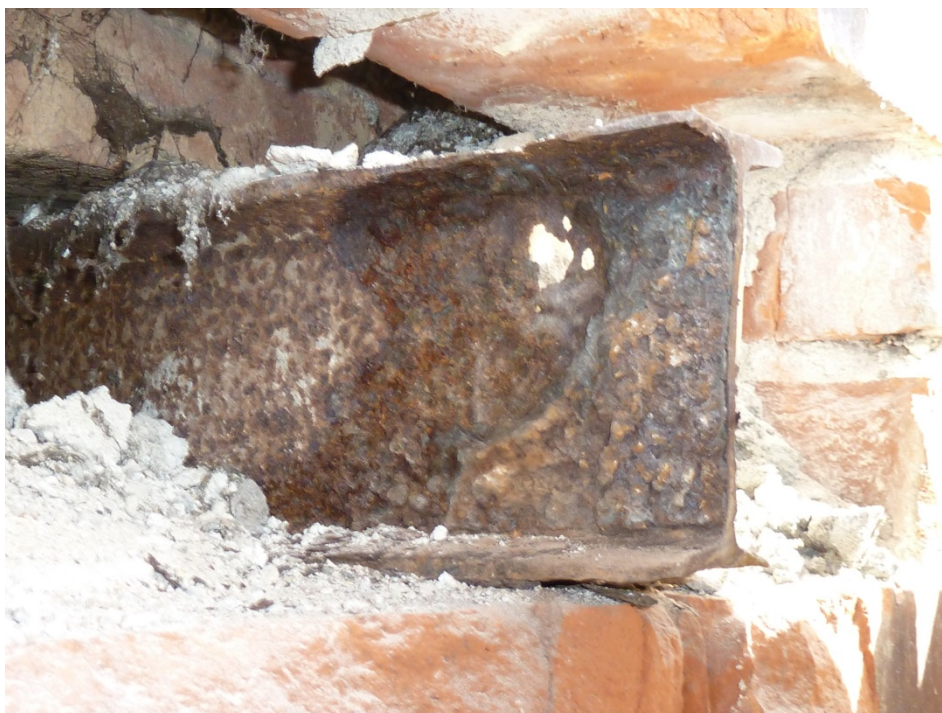
Figur 14, Udliggerjern fra altan under den nedfaldne, efter ophugning.
