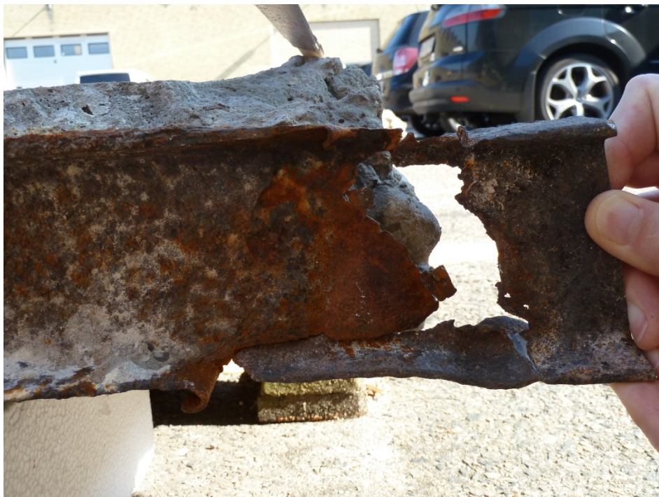
Figur 15 Korrosionszone i kollapset udliggerjern. Tommestokken angiver beliggenheden af facadeplanet. Stykket til venstre ses i sin helhed i figur 16.
