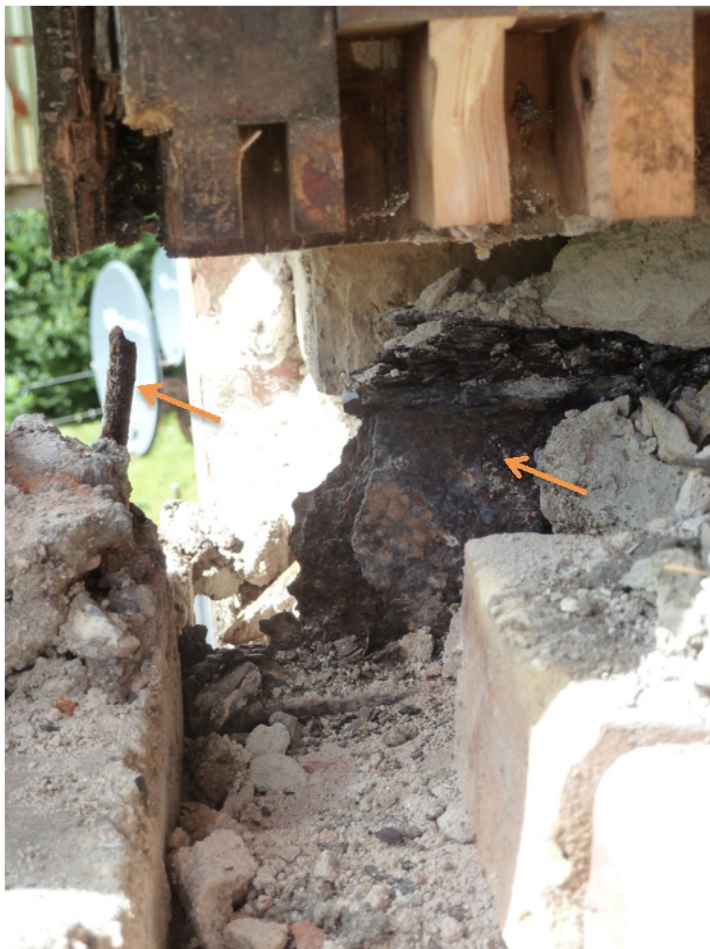
Figur 9 Udliggerjern siddende i facaden set fra siden bag altandør, Ø8 rundjern ses også i bunden af altanpladen
