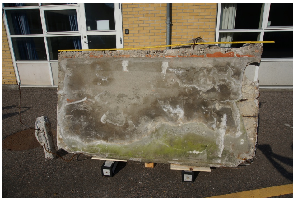
Figur 17 Underside af kollapsede altanplade (Foto: Pelcon ApS)
